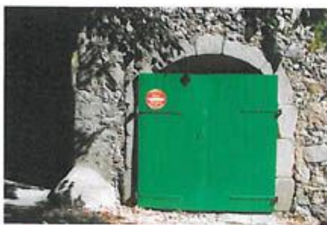
La pose d'un portail standardisé qui ne respecte pas la structure de l'ouverture
