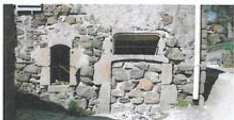
Luciers : traces multiples de modification des ouvertures au fil du temps
