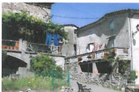
Luziers - Eviter les garde-corps à barreaudage bois, protection type chalet de montagne
