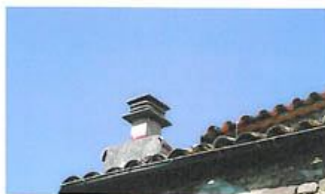
Mas Soubeyran. La structure initiale de la cheminée n'a pas été respectée
